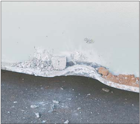
▲被撞桥体已发生部分变形。 记者 张敏 摄
