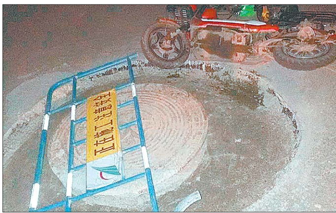
邵先生的电动车摔倒在井盖施工现场,护栏已经倒地。受访者供图
