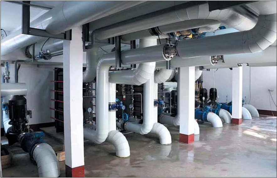
升级改造后的标准化供热站。
