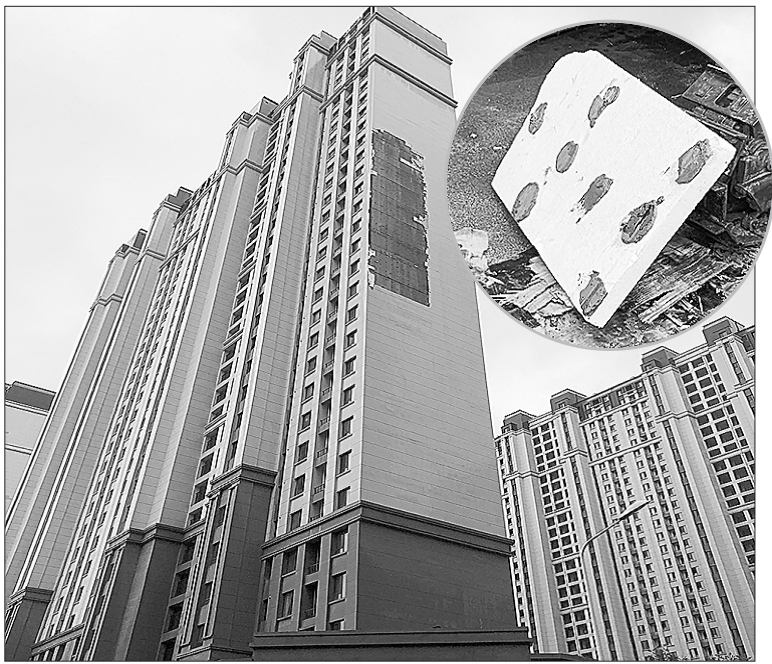
楼栋外墙保温层掉落。小图为脱落的保温层。 记者 张国桐 摄
